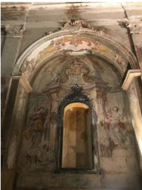
Una cappella laterale di San Pietro Martire in cui è possibile osservare il degrado degli affreschi
